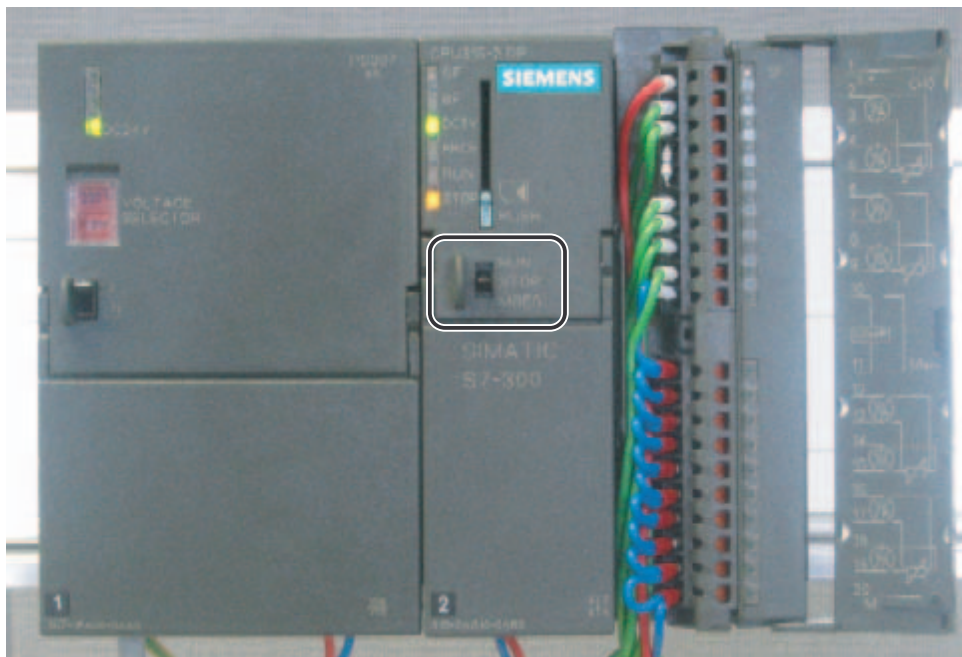
图片 5-5 已成功接线，CPU 处于 STOP 位置
