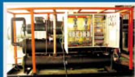
螺杆机冷水机组控制系统
